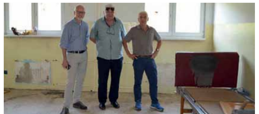
Die jetzt endlich geräumte Außenstelle in Zovic, in der schwerstmehrfachbehinderte Menschen jahrelang unter menschenunwürdigen Bedingungen leben mussten.
